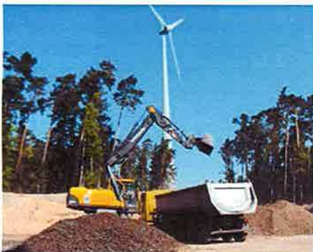
Windpark Binselberg D
